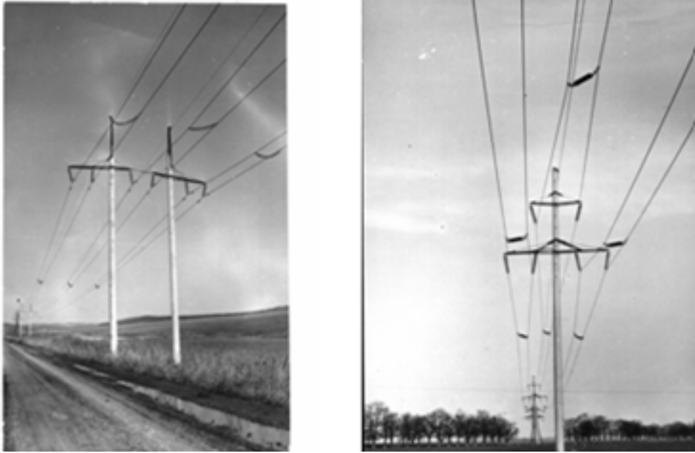
Рис. 9. Первая в мире управляемая двухцепная самокомпенсирующаяся высоковольтная линия электропередачи 110 кВ (СВЛ-110 кВ).
